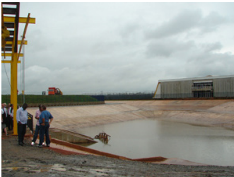
FIGURA 76 – RESERVATÓRIOS DE DETENÇÃO
